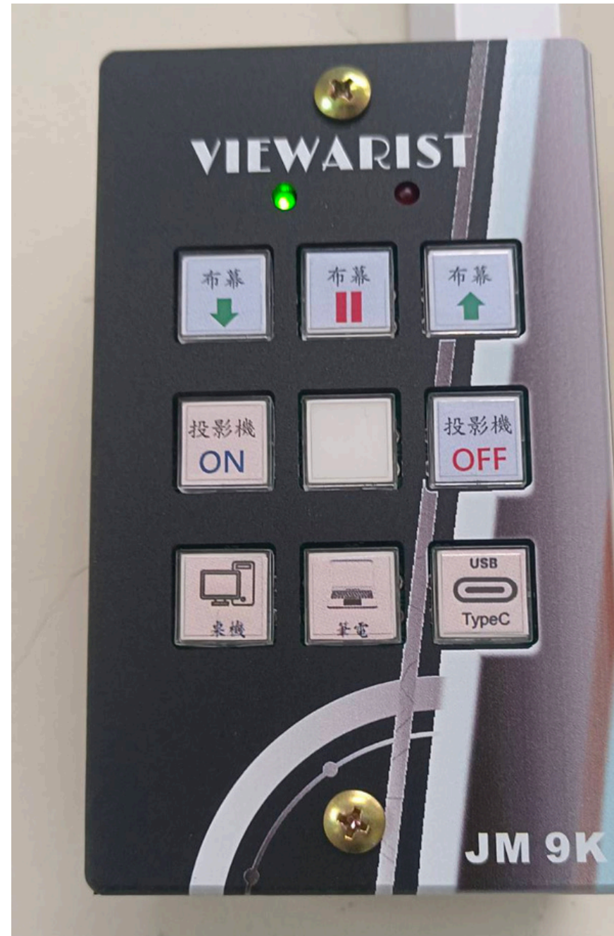
資訊設備控制面板
