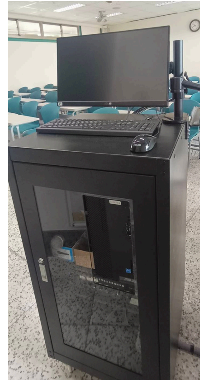
資訊設備機櫃
